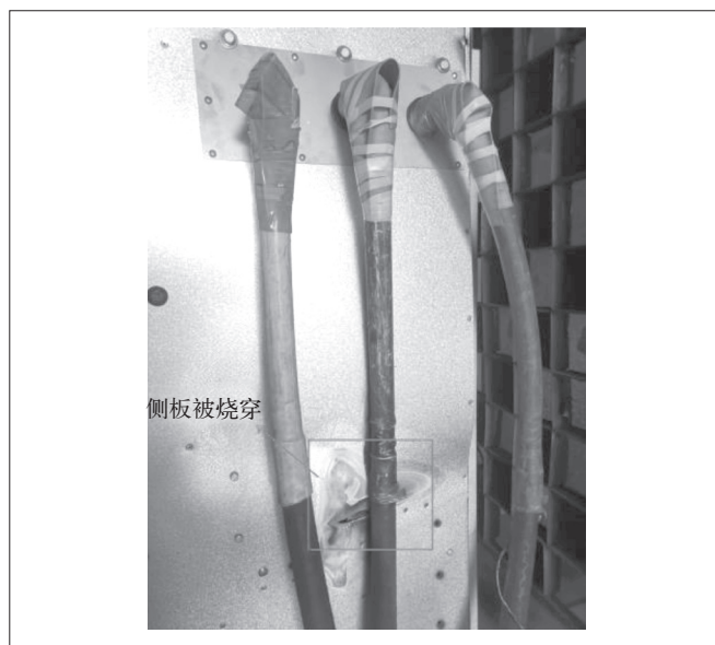
图7 侧板烧损情况图
