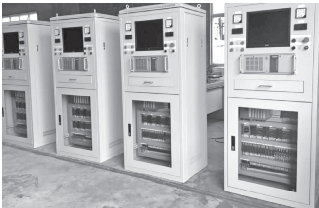
图1 机电仪控机柜
