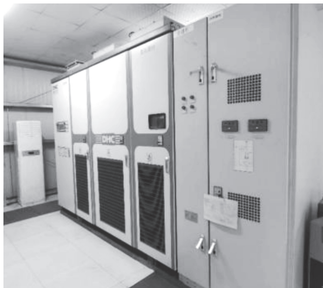
图 2 循环水泵新增的 6.3kV 高压变频系统
