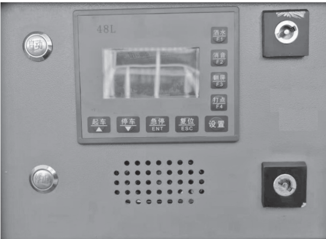
图 3 矿用液压泵站保护装置界面
