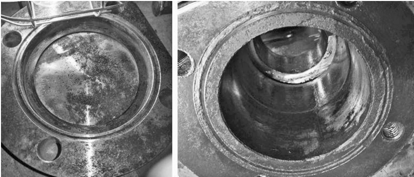
图 4 下阀盖与阀体结合面的磨损、锈蚀情况
