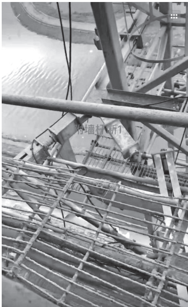
图 1 安装角度因素导致附墙杆开裂
