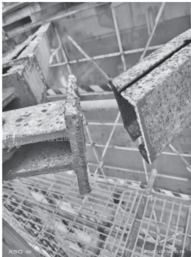
图 2 焊接工艺问题导致附墙杆断裂
