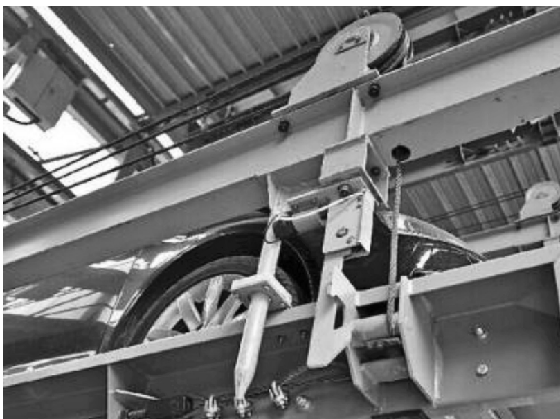
图 3 防载车板坠落装置
