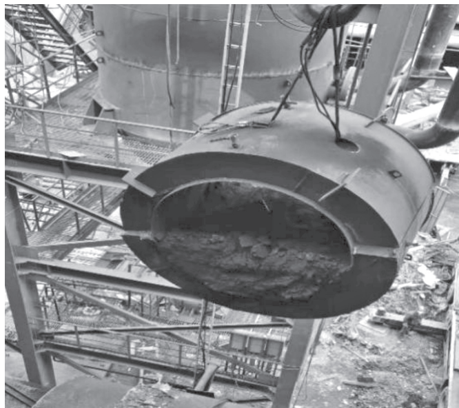
图 1 管道中下部积灰
