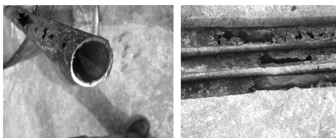
图 1 加热器腐蚀内漏外观图
