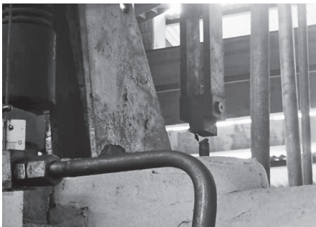
图 2 调节气阀南侧阀杆断裂，阀杆与方头螺纹连接部位防转销孔
