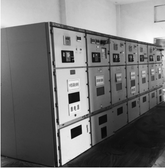
图 1 变电室高压柜
