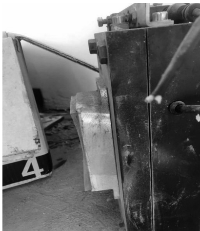
图 1 制动器闸瓦磨损严重、粉屑较多
