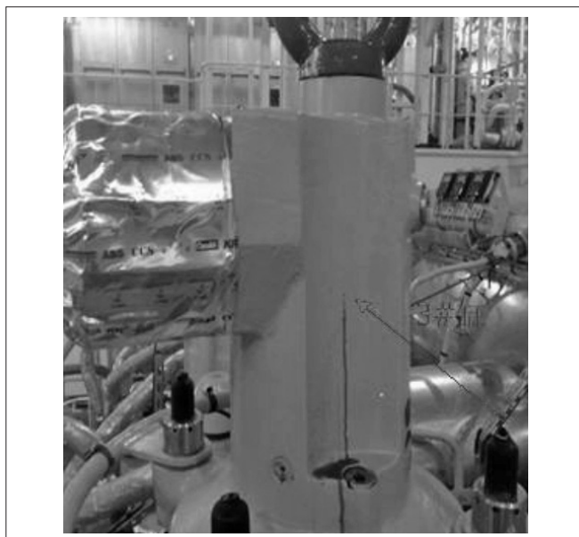
图1 两件油缸漏油区域
