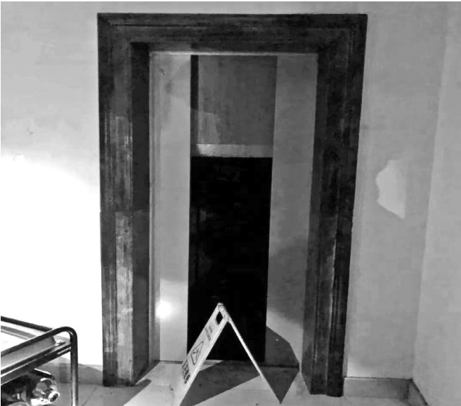
图 1 电梯机械失效事故现场电梯箱所在位置
