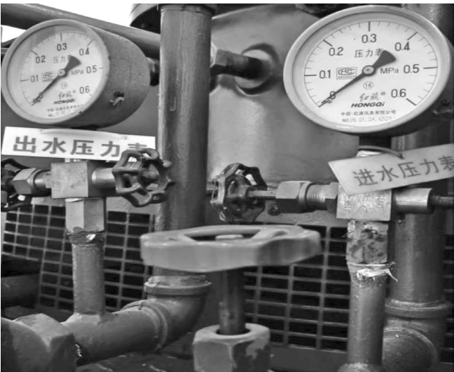
图 1 电动机上导轴承冷却器进出水口压力表实物图
