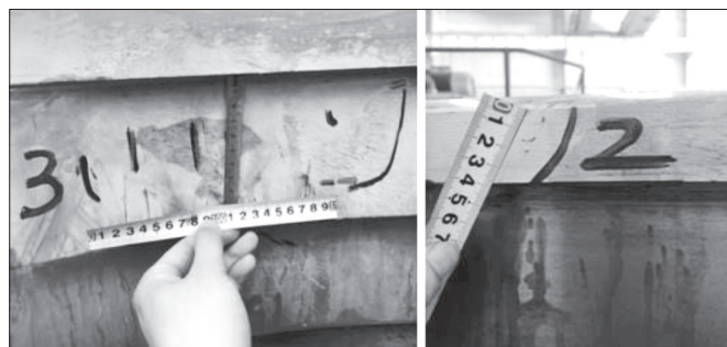
图 1 隔板焊接缺陷、焊接裂纹、焊接未融合
