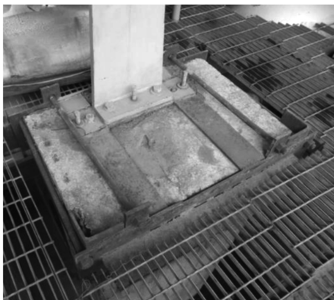
图4 气缸支撑灌浆层裂纹
