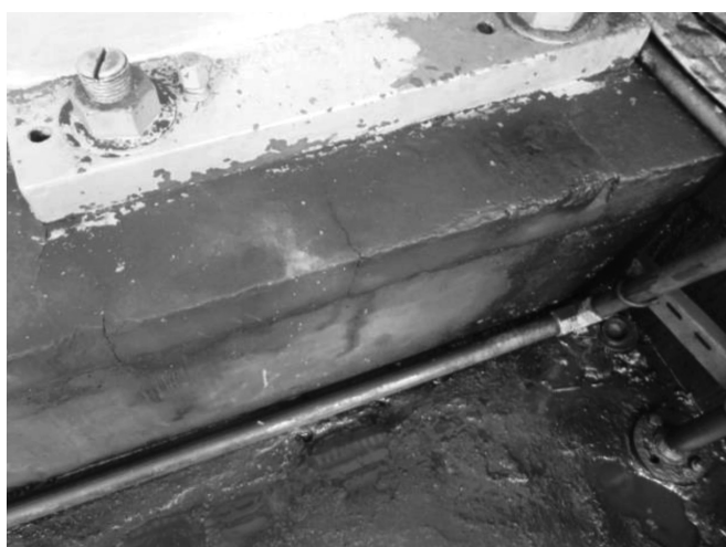
图5 中体灌浆层裂纹
