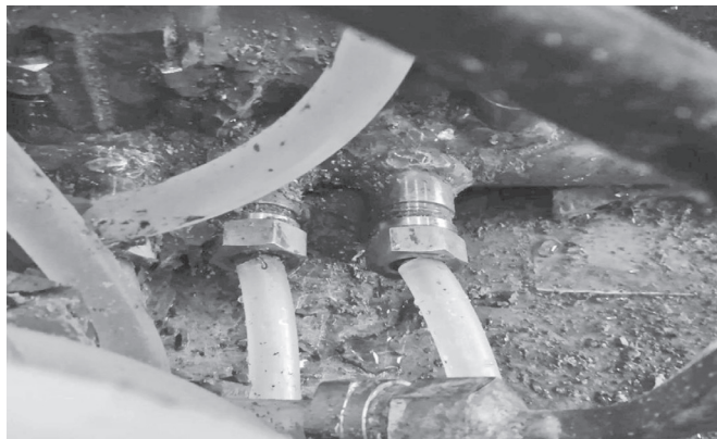
图 2 F46 管与汇流管分支接头处断裂
