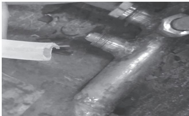
图 3 F46 管断裂实物局部图
